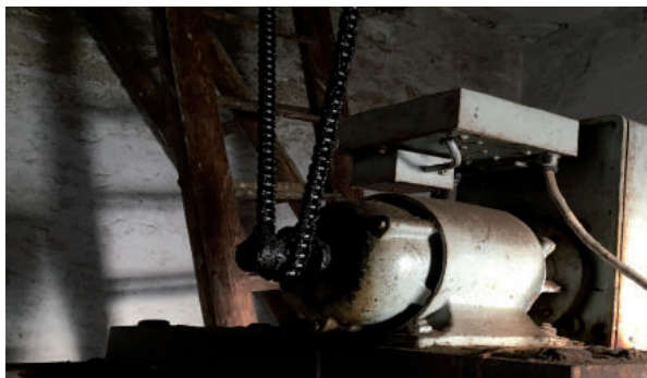
Abgenutzter Motor der großen Glocke aus den 40er Jahren des 20. Jahrhunderts
